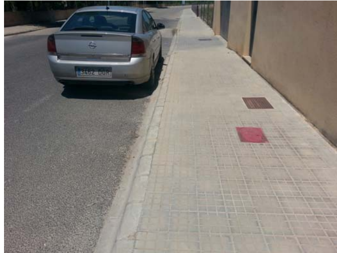
12. Hidrant soterrat de 1 boca de diàmetre ràcord Barcelona 70 en interior d'arqueta vermella però connectat a xarxa de proveïment sense aigua. Cal connexió per part de l'Ajuntament ( no inclòs a aquest projecte)
